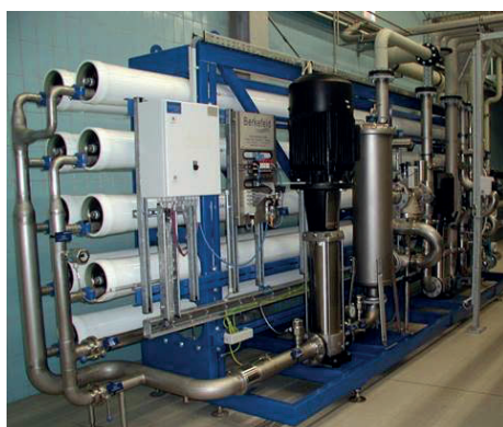
Nanofiltrations-Anlage, bestehend aus mehreren Membranmodulen in einem Wasserwerk.
